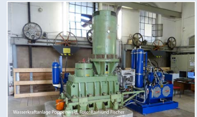
Wasserkraftanlage Poppenwald, Foto: Raimund Fischer
