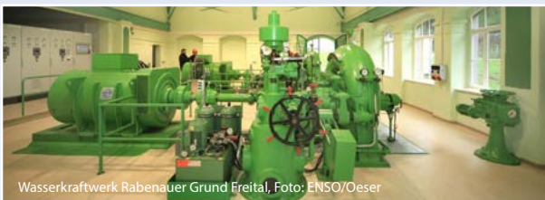
Wasserkraftwerk Rabenauer Grund Freital, Foto: ENSO/Oeser
